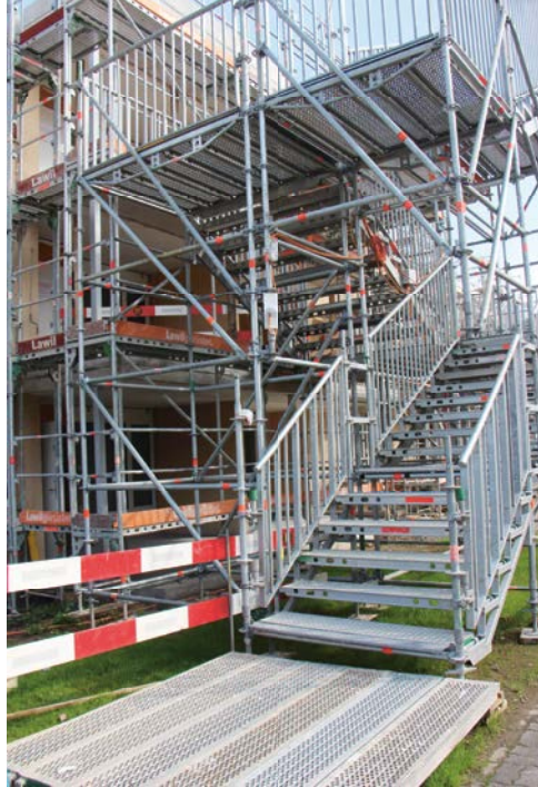
Der Treppenturm gilt als Provisorium, damit die Bewohner während der Sanierungsphase in ihre Wohnungen können.
