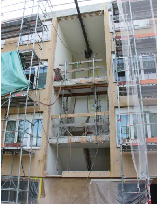
Den Passanten bietet sich nach sieben Wochen Bauzeit ein faszinierender Einblick in das Innenleben des Treppenhauses.
